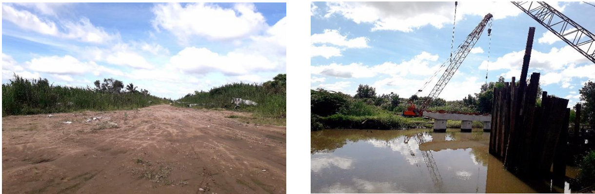
Hình 11. Hiện trạng san lấp làm đường và cầu nối giữa khu đô thị Ngã bảy 1 và Ngã Bảy 2
